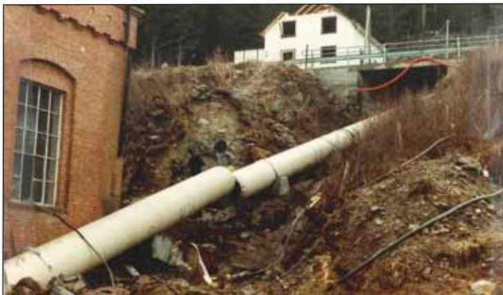
Oversikt over bruddsted med skadet bolighus. Foto NVE.
